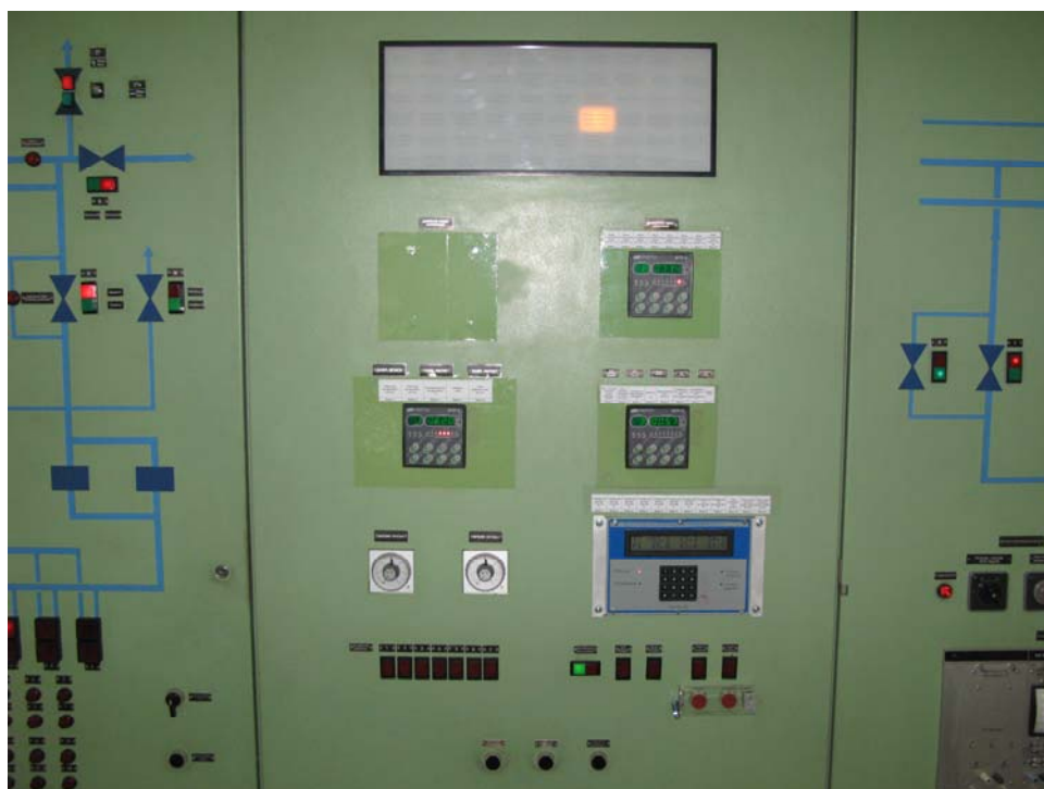
Рис. 1. Монтаж микропроцессорных приборов UA-112 и МТР-8 в щите управления КС-2
